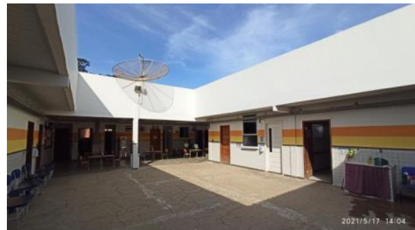
ILUSTRAÇÃO 24 – Salas de aula com desnível nas portas
