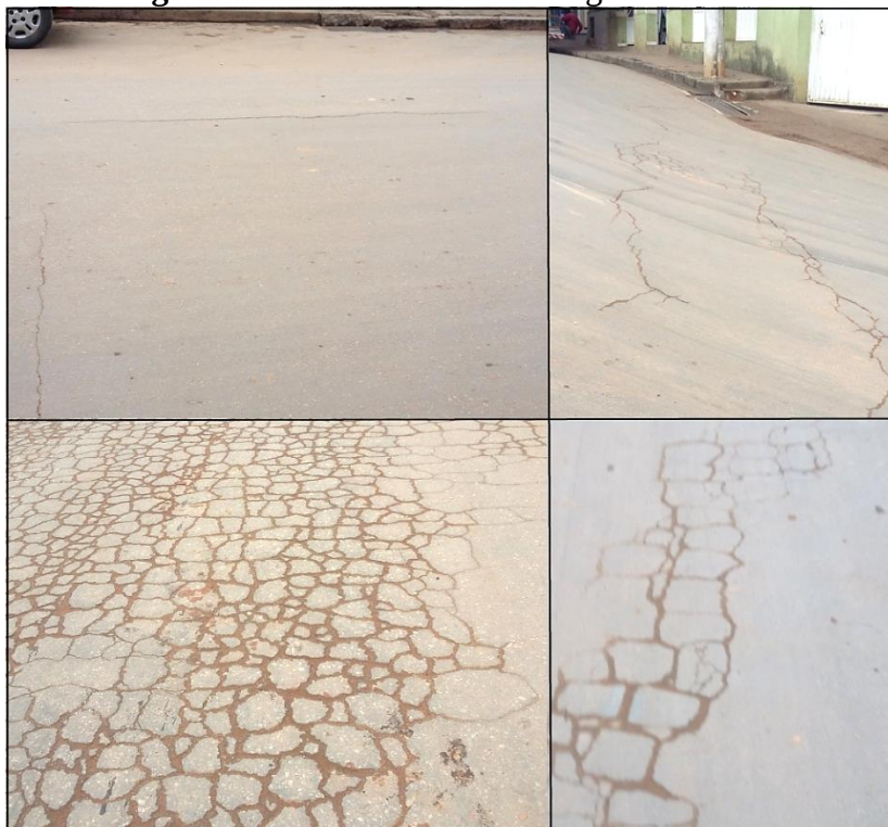
Figura 3 – Fendilhamento ao longo dos trechos
