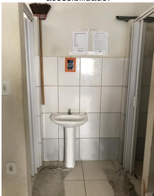
Figura 10 – Banheiro sem acessibilidade.
