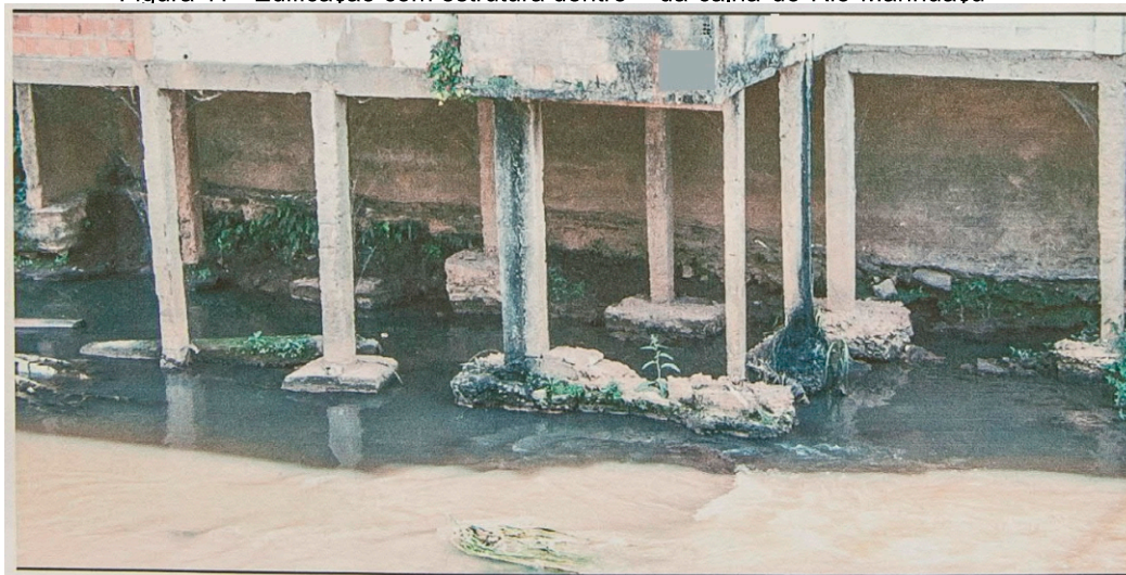
Figura 11 - Edificação com estrutura dentro da calha do Rio Manhauçu
