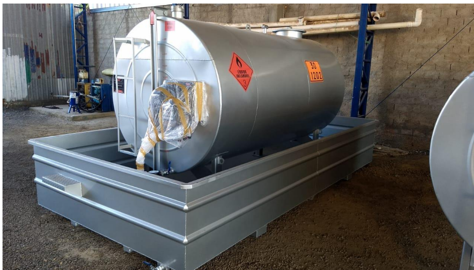
FIGURA 1: Tanque de armazenamento de combustíveis.
