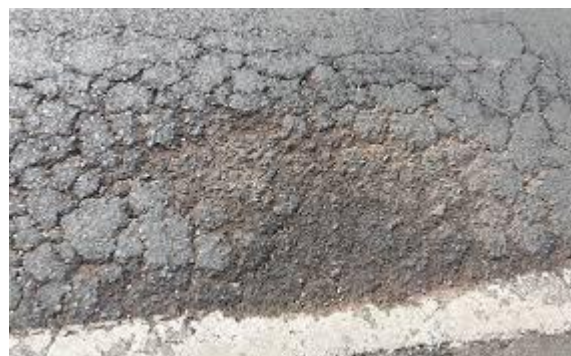
Figura 09: Exemplo de desgaste do asfalto.
