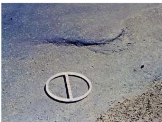
Figura 10: Exemplo de escorregamento.
