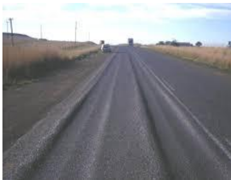
Figura 07: Exemplo de afundamento de consolidação de trilha de roda.
