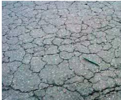
Figura 11: Trinca tipo bloco
