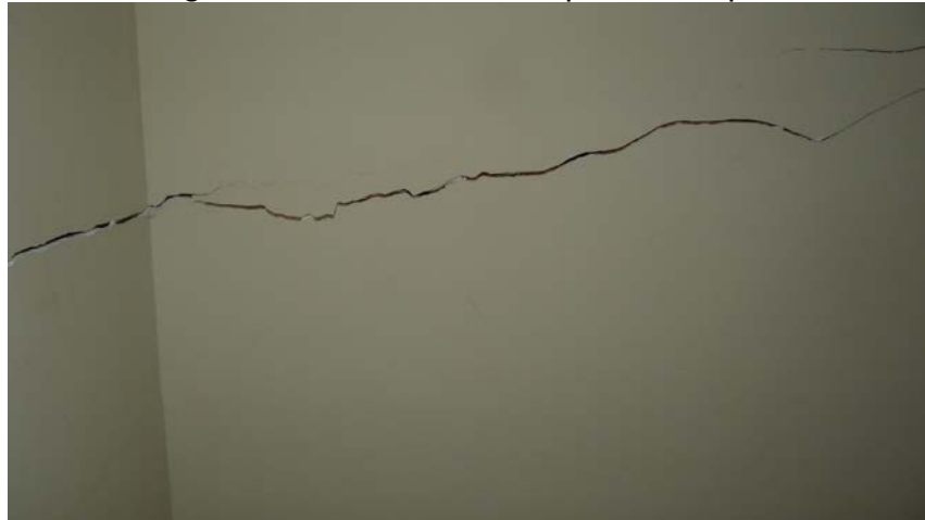
Imagem 10 – Rachadura do painel do quarto
