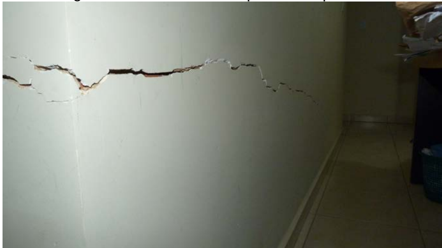
Imagem 11 – Rachadura do painel do quarto suíte
