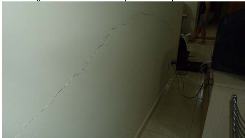
Imagem 9 – Rachadura aparente no painel na sala
