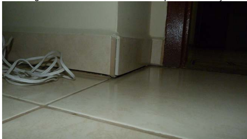
Imagem 7– Descolamento do rodapé na circulação
