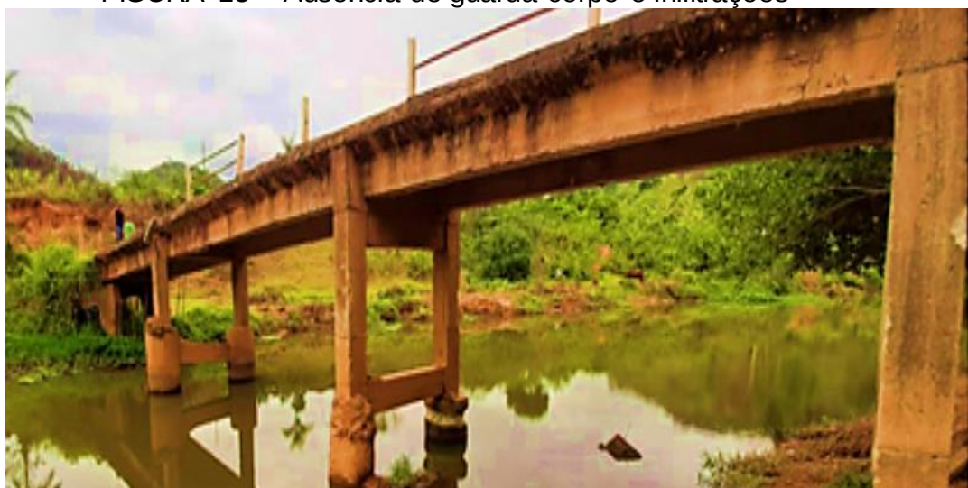
FIGURA 15 – Ausência de guarda-corpo e infiltrações
