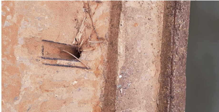
FIGURA 16 – Armadura exposta e furo no tabuleiro da ponte
