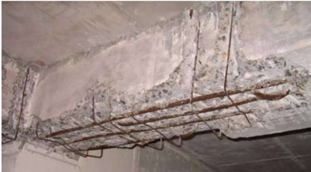
FIGURA 5 - Desagregação do concreto em viga
