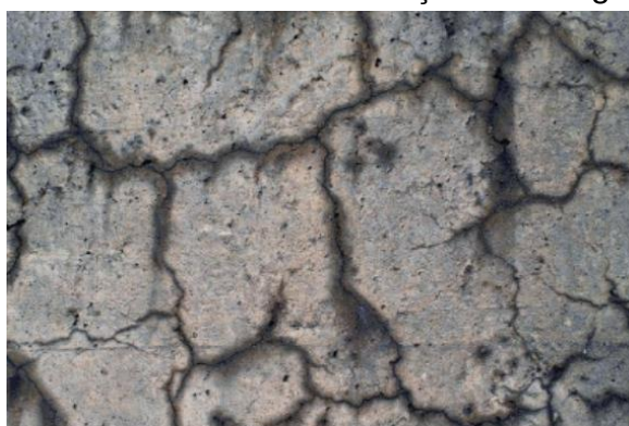
FIGURA 10 – Concreto sob reação álcali-agregado
