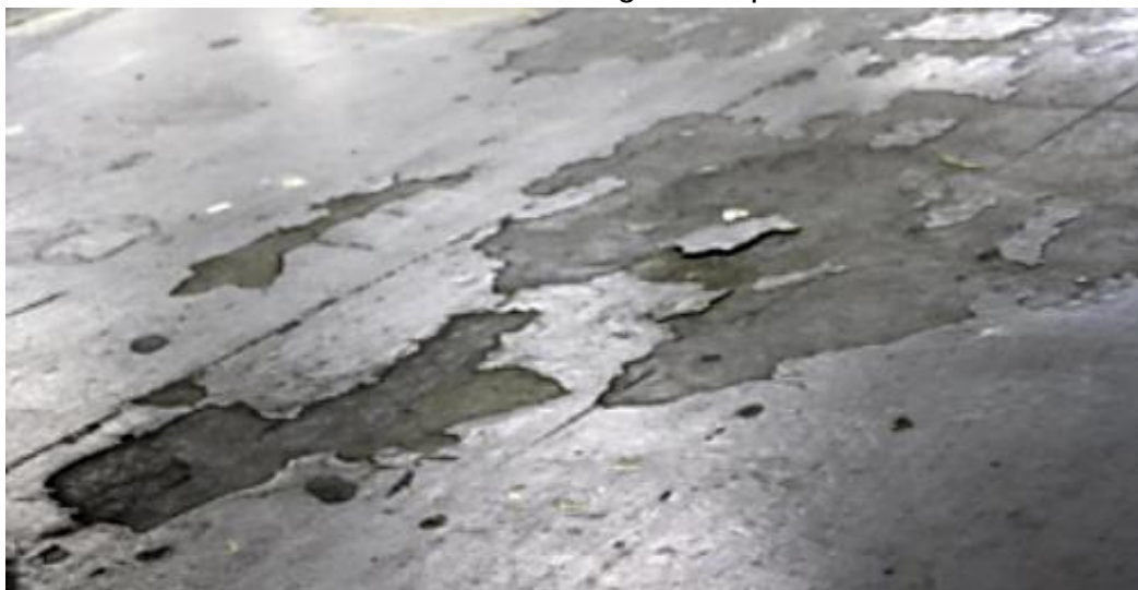
FIGURA 6 - Piso desgastado por abrasão
