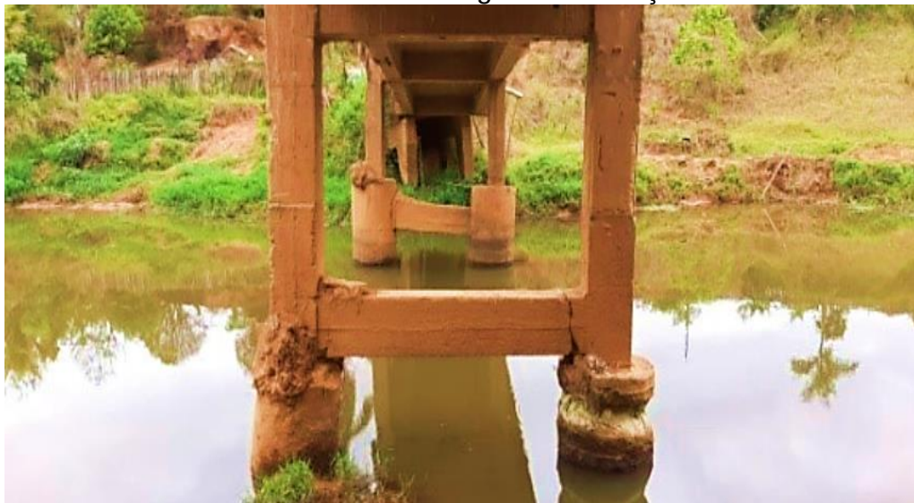
FIGURA 17 – Patologia nas fundações
