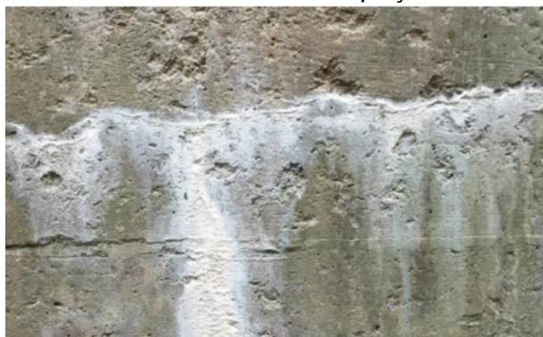
FIGURA 9 - Eflorescência em peça de concreto
