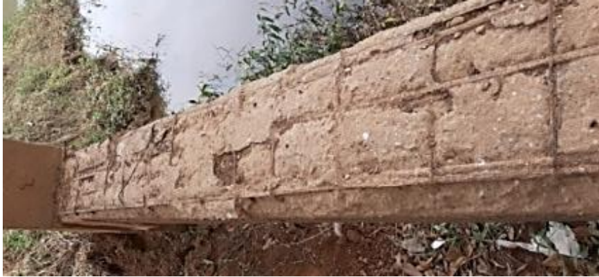
FIGURA 18 – Exposição da armadura e deslocamento do concreto
