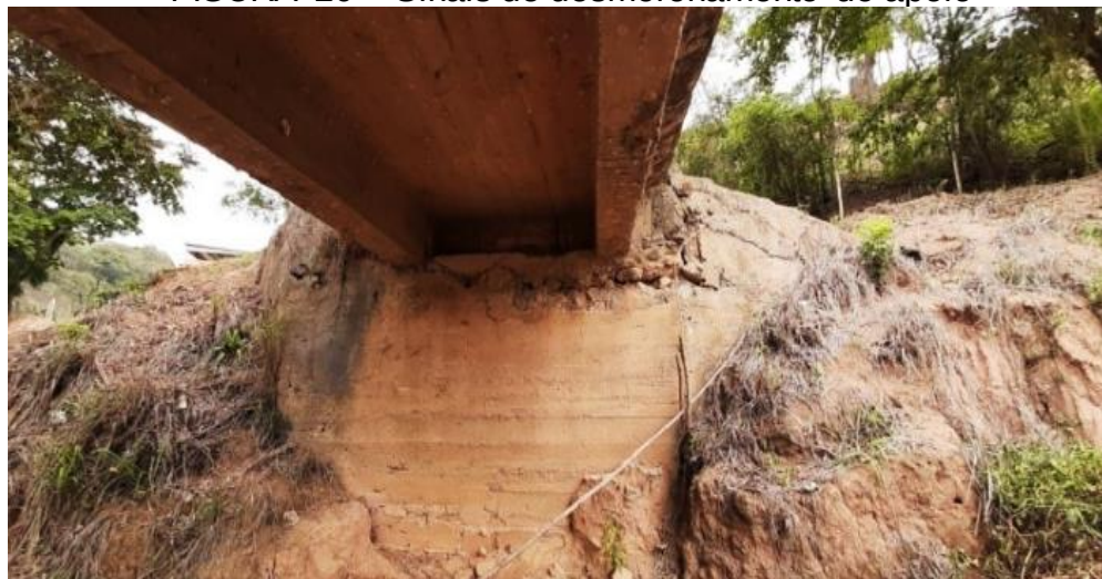
FIGURA 20 – Sinais de desmoronamento do apoio
