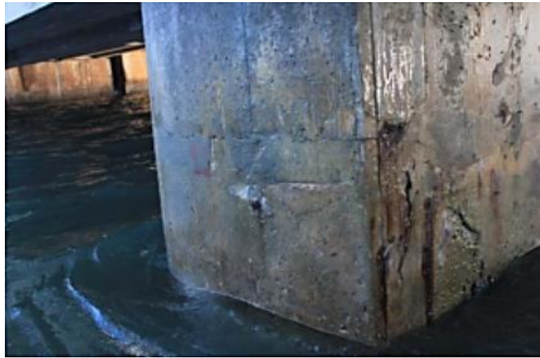
FIGURA 7 – Pilar erodido pela ação da água
