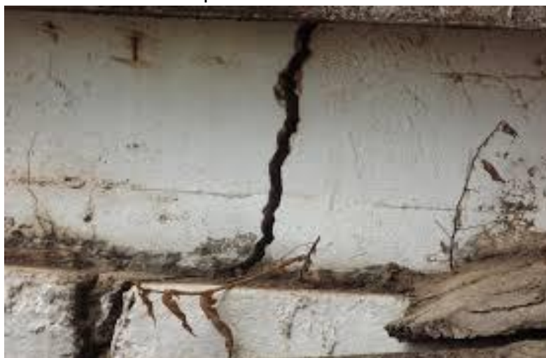
FIGURA 3 - Trinca em ponte de concreto armado - Brasília/DF
