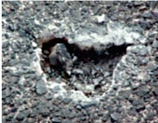
FIGURA 8 – Cavitação em estrutura de concreto
