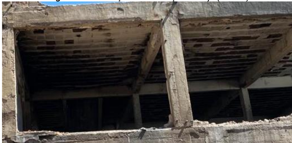
Figura 13: Presença de deformação em laje (flechas)
