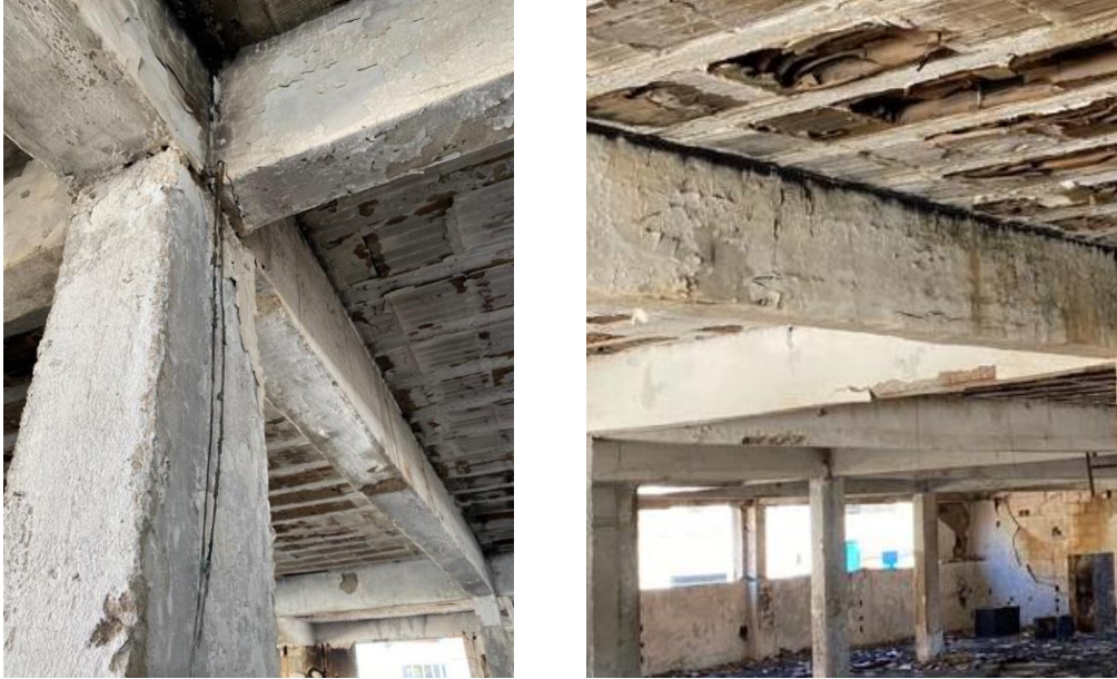
Figuras 10 e 11: Presença de esfarelamento superficial em pilares e vigas
