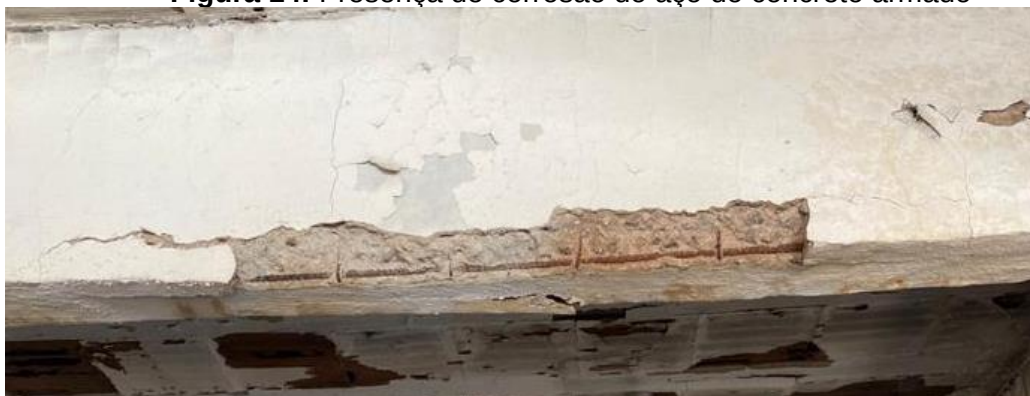
Figura 14: Presença de corrosão do aço do concreto armado
