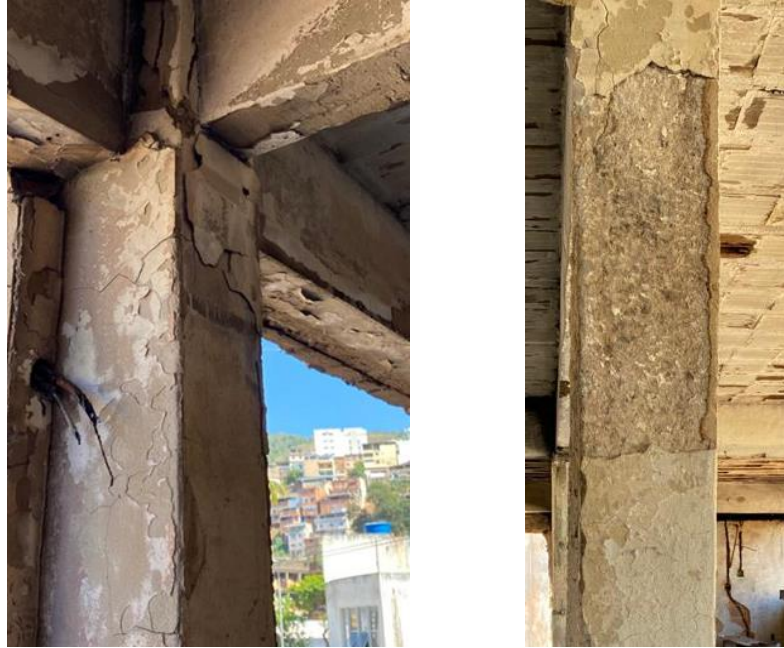
Figuras 6 e 7: Presença de lascamento superficial em pilares e vigas
