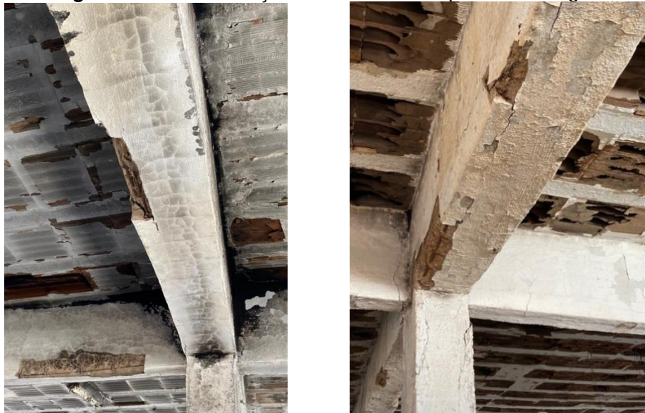
Figuras 8 e 9: Presença de lascamento explosivo em vigas
