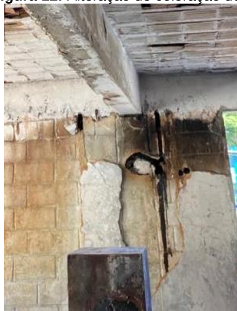
Figura 12: Alteração de coloração do concreto
