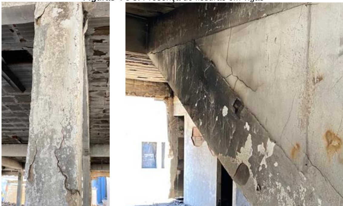
Figuras 4 e 5: Presença de fissuras em vigas
