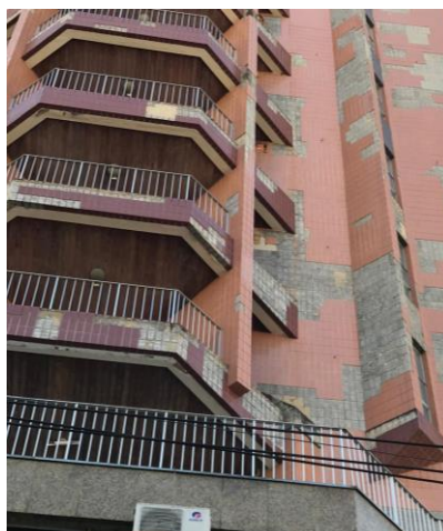
FIGURA 2 – Destacamento ou deslocamento do RCF
