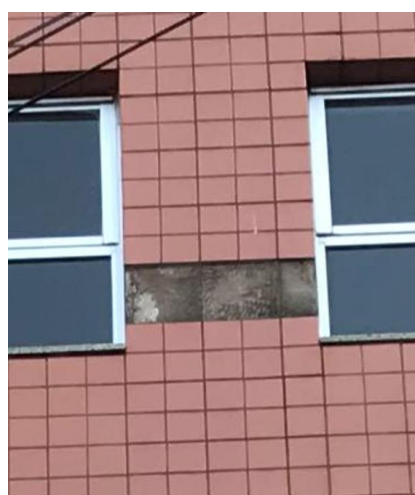
FIGURA 3 – Destacamento ou deslocamento do RCF
