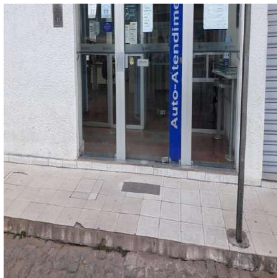
Figura 12 – Inexistência de rampa
