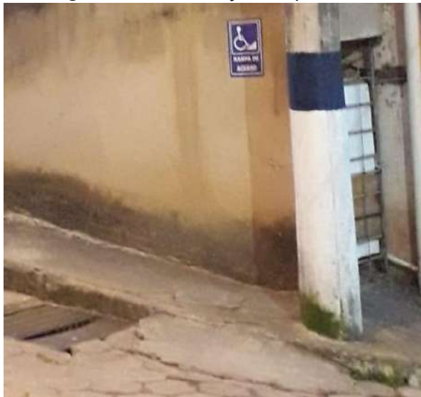
Figura 15 – Obstrução do passeio
