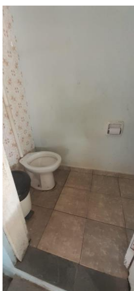
Figura 22 – Sanitário inacessível com presença de degrau na sua entrada
