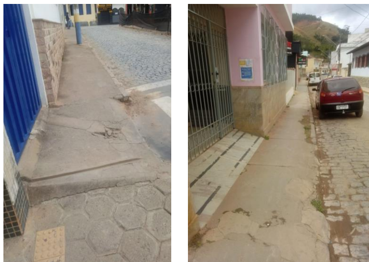
Figura 03 – Situação das calçadas da cidade de Abre Campo - MG
