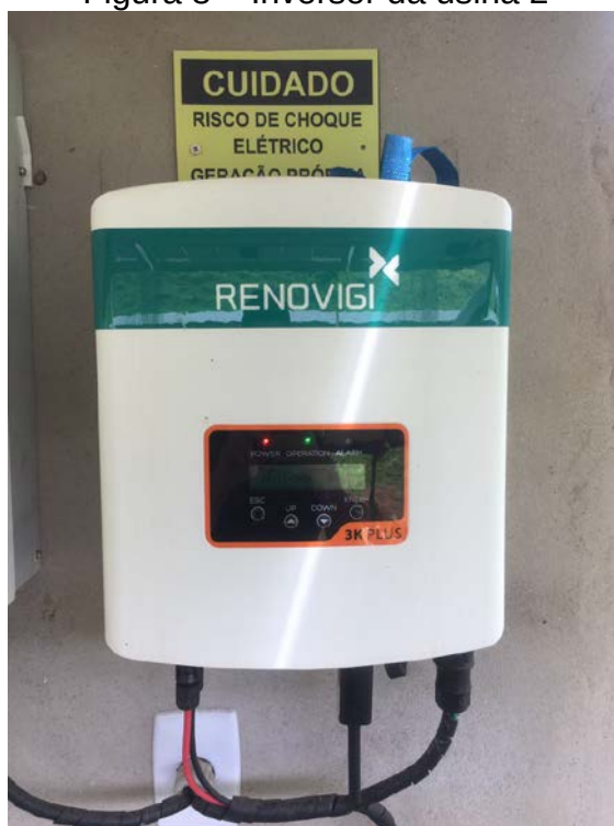
Figura 8 – Inversor da usina 2
