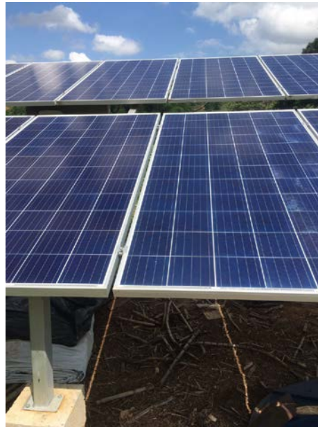
FIGURA 5 – Painéis fotovoltaicos 320W usina 1
