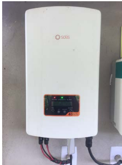
FIGURA 6 – Inversor da usina 1
