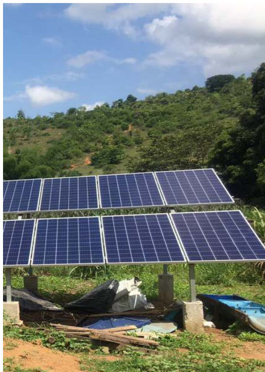
FIGURA 7 – Painéis fotovoltaicos 330W usina 2
