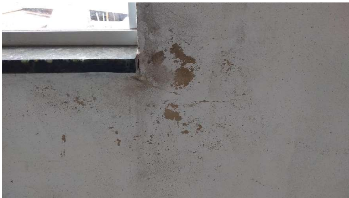
FIGURA 5 – Eflorescência em revestimento com pintura interna - edificação 1
