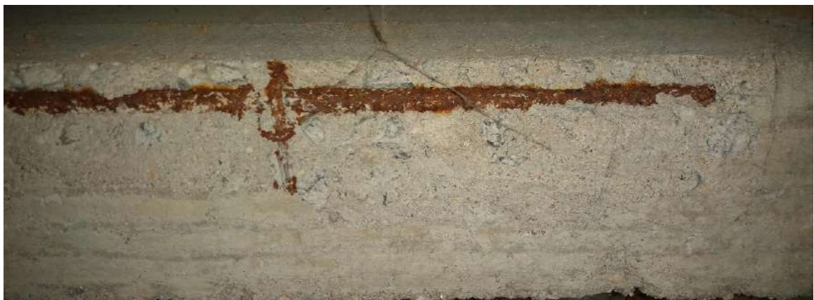
FIGURA 16 – Viga com armadura exposta - edificação 1
