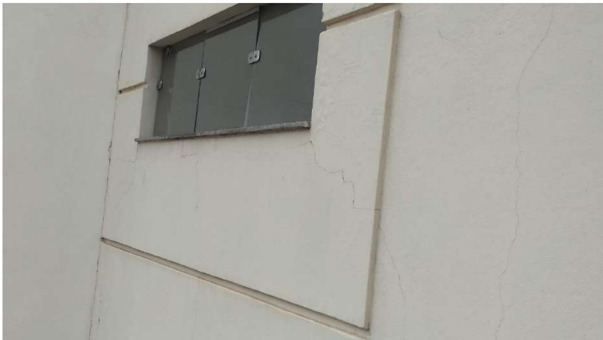
FIGURA 10 – Trincas 45° abaixo das janelas - edificação 2
