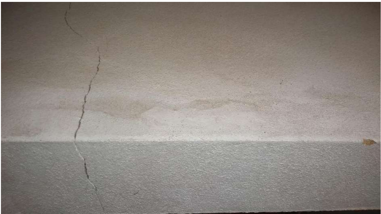
FIGURA 9 – Trincas acima da passagem das portas internas - edificação 1
