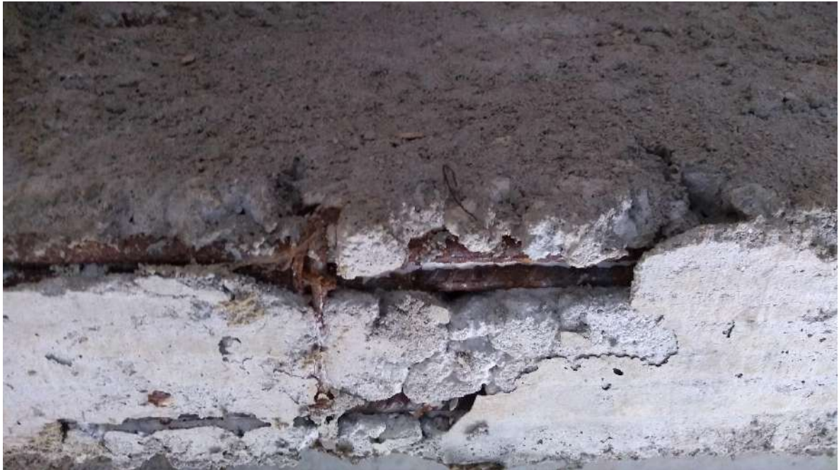
FIGURA 15 – Viga com Armadura Exposta - edificação 1
