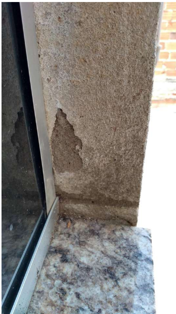
FIGURA 6 – Eflorescência em revestimento com pintura externo - edificação 1
