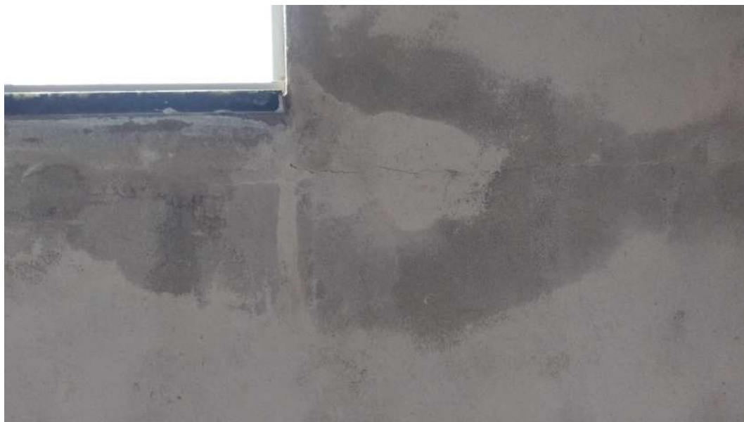
FIGURA 17 – Infiltração na Parede - edificação 1
