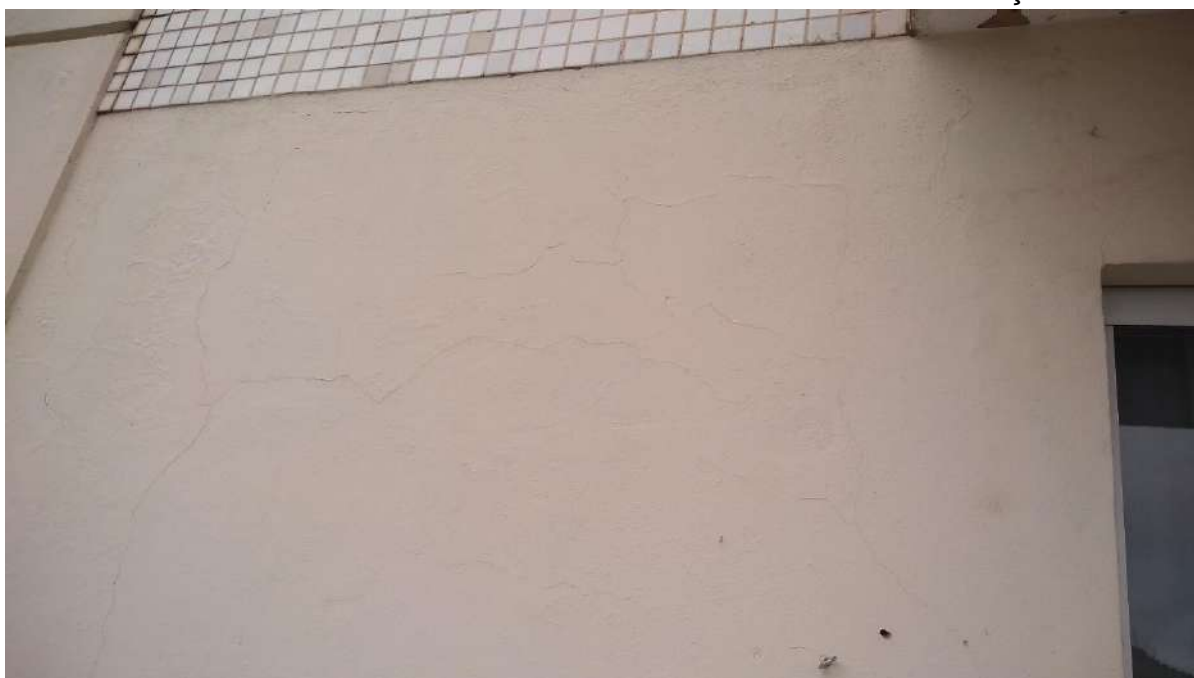
FIGURA 12 – Fissuras na Fachada do Edifício - edificação 2
