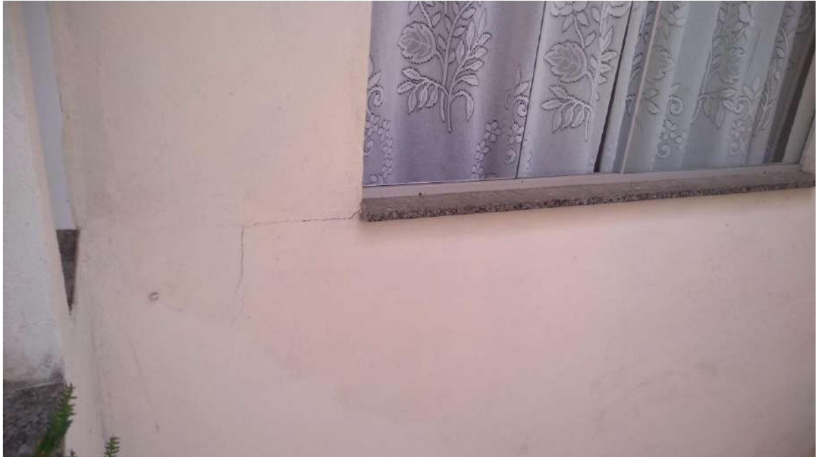
FIGURA 8 – Trincas 45° abaixo das janelas - edificação 2
