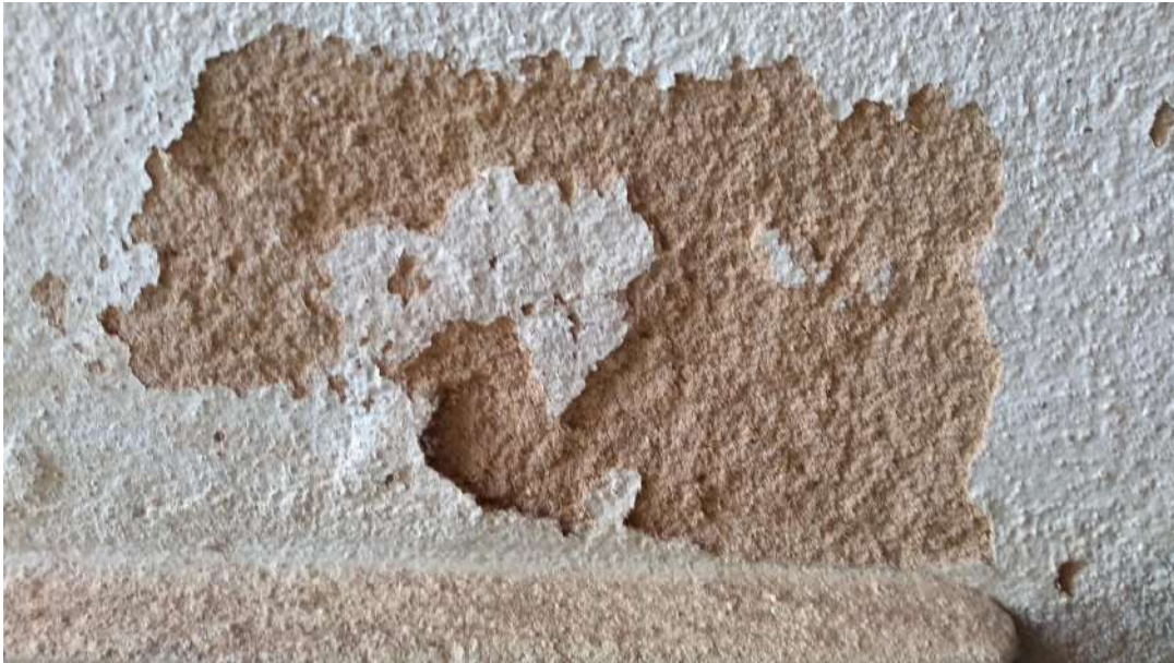
FIGURA 3 – Eflorescência em revestimento com pintura interna
