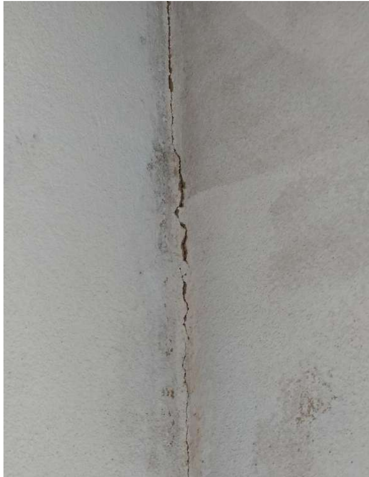
FIGURA 14 – Trincas Vertical na Parede - edificação 2
