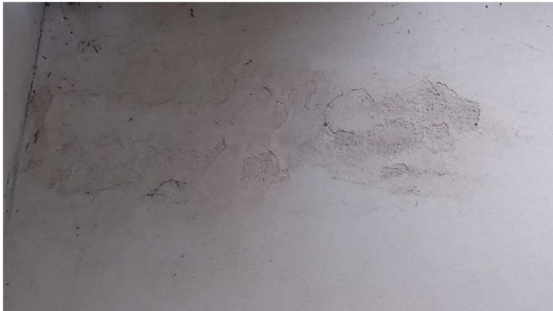
FIGURA 4 – Eflorescência em revestimento com pintura interna - edificação 2
