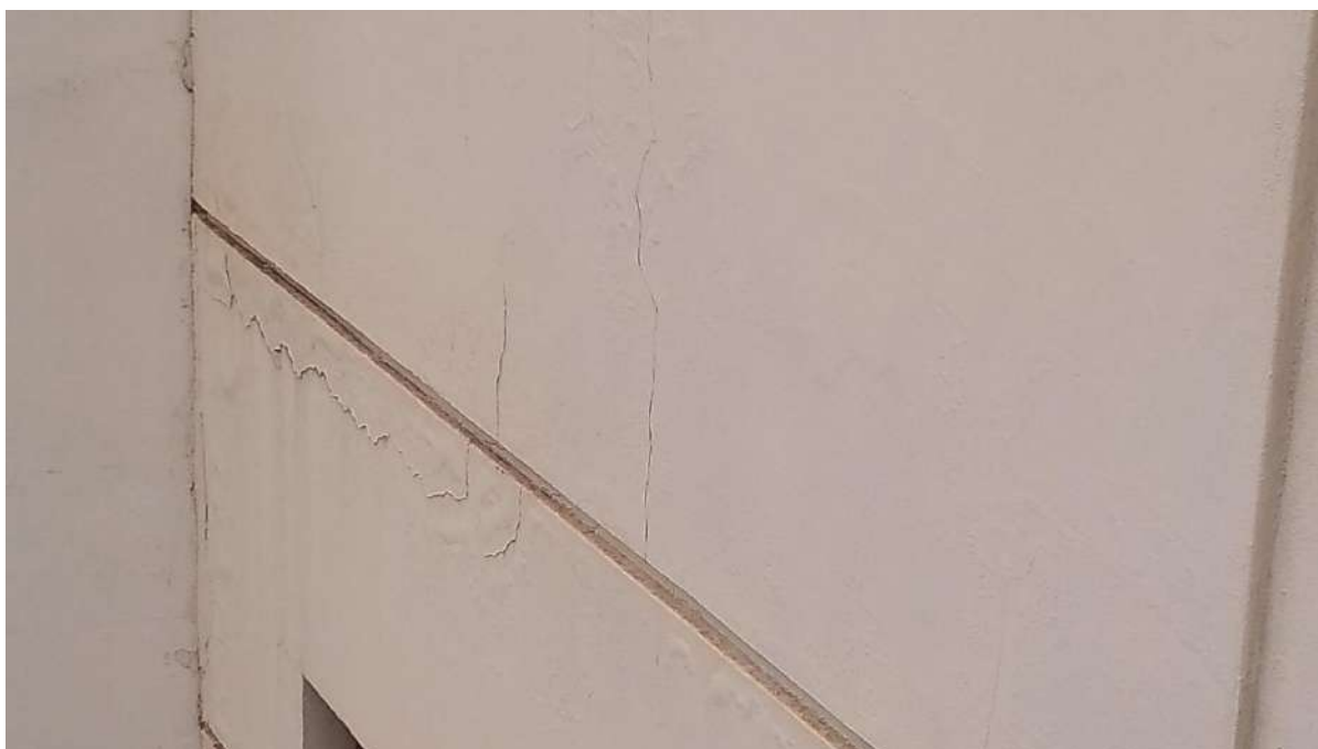
FIGURA 13 – Trincas, Fissuras e Destacamento da Tinta - edificação 2
