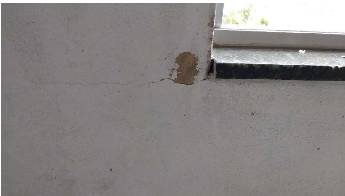
FIGURA 7 – Trincas 45° abaixo das janelas - edificação 1
