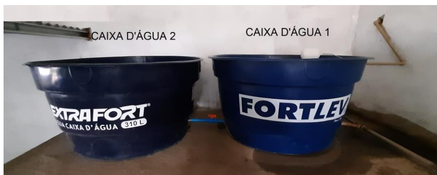
FIGURA 4- Disposição dos reservatórios.
