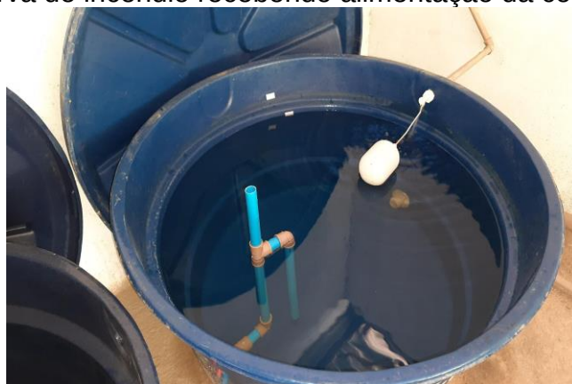
FIGURA 9- Reserva de incêndio recebendo alimentação da concessionária local.
