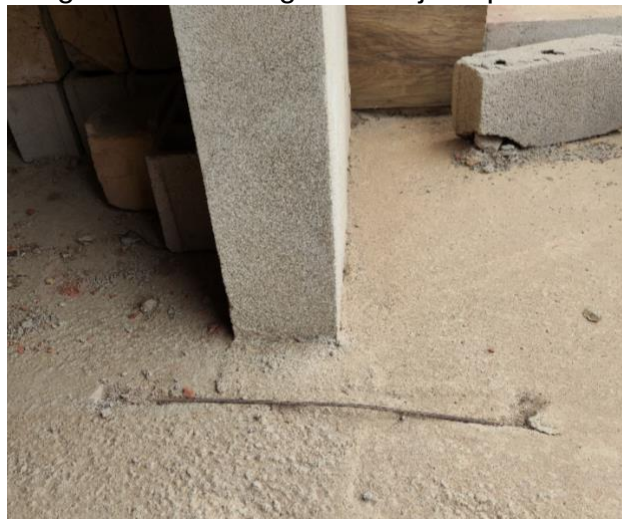
Figura 15 – Ferragem da laje exposta.
