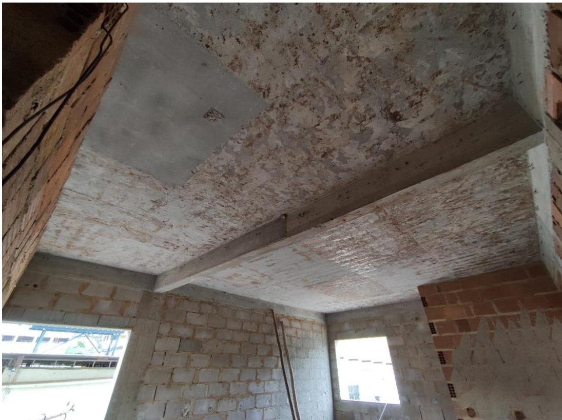
Figura 12 – Laje sem nenhuma passagem das instalações elétricas e hidrossanitárias.
