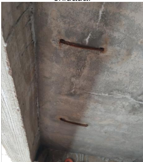
Figura 14 – Ferragem da laje exposta com aparência bem oxidada.
