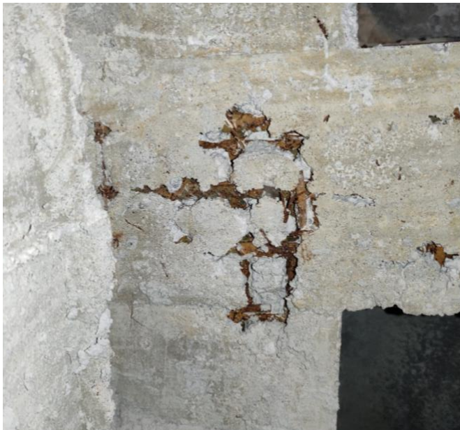
Figura 13 – Cruzamento de duas vigas com falha na concretagem e com ferragem oxidada.
