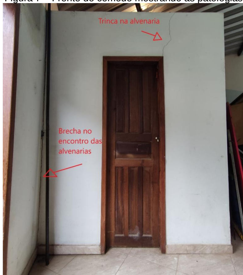
Figura 7 – Frente do cômodo mostrando as patologias.
