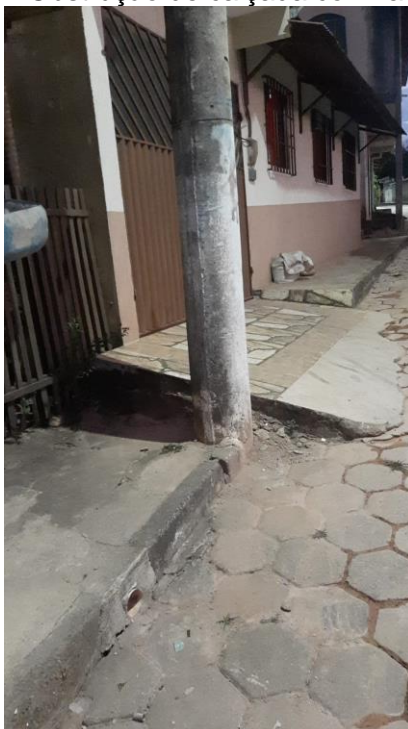
Figura 1. Obstrução de calçada com rampa de acesso.
