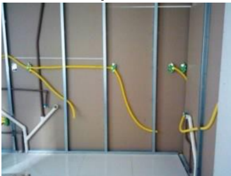
FIGURA 5 - Passagem elétrica e hidráulica.
