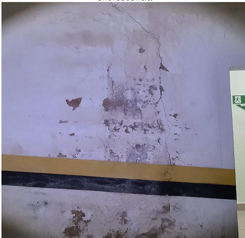
FIGURA 11 – Manchas de umidade, fissura, descascamento, bolhas na pintura e eflorescência
