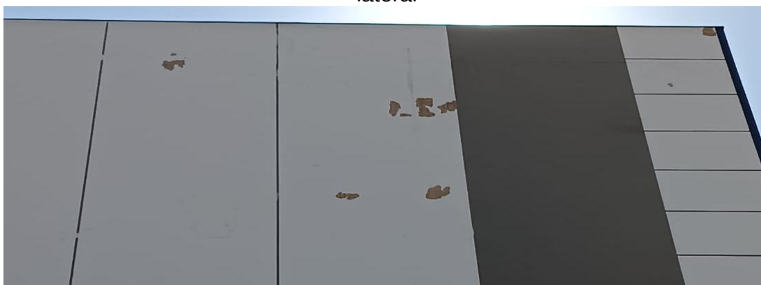
FIGURA 18 – Desagregação do revestimento argamassado no topo da fachada lateral
