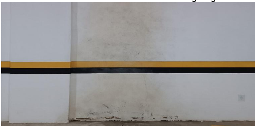
FIGURA 9 – Manchas de umidade na garagem
