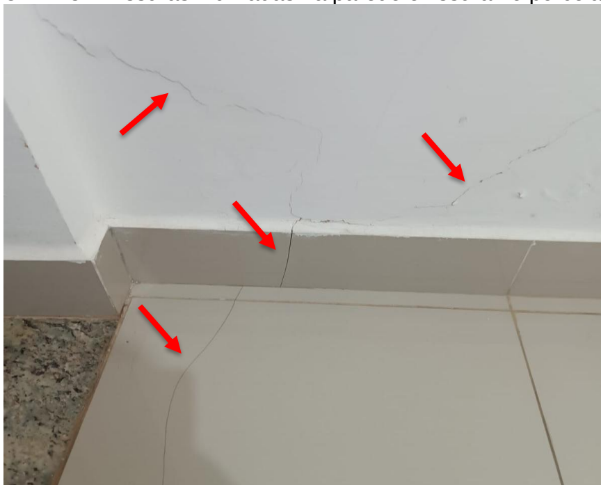
FIGURA 13 – Fissuras inclinadas na parede e fissura no porcelanato
