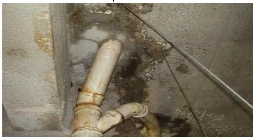
FIGURA 2 – Mofo proveniente de vazamento
