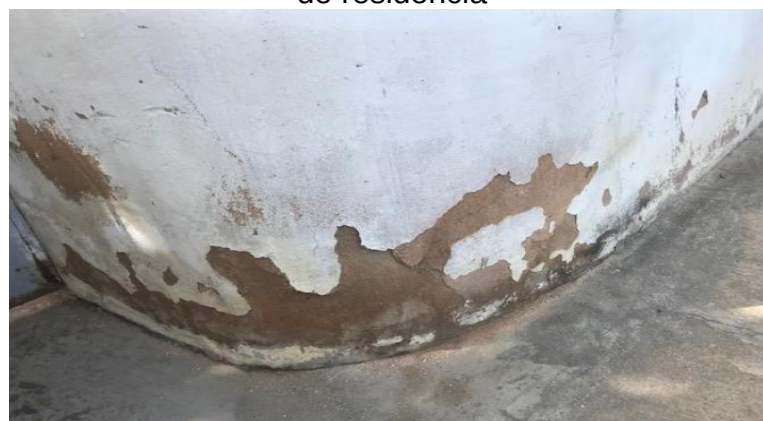
FIGURA 4 – Descascamento da pintura e desagregação da argamassa da fachada de residência
