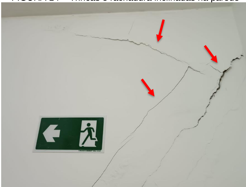
FIGURA 14 – Trincas e rachadura inclinadas na parede
