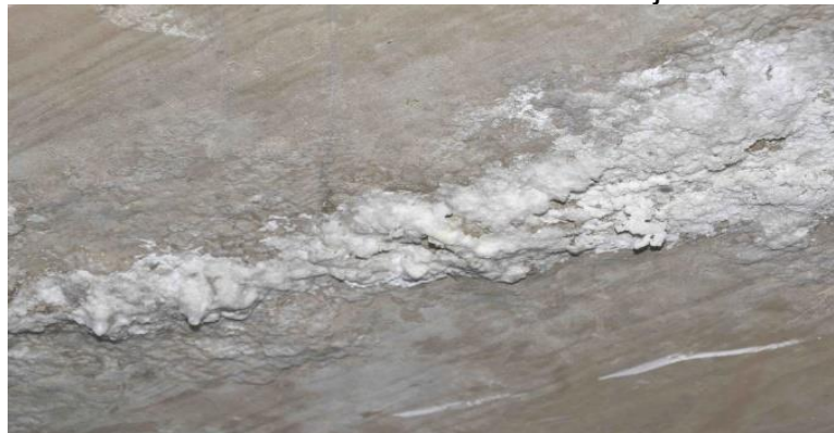
FIGURA 3 – Mancha de eflorescência na laje de concreto
