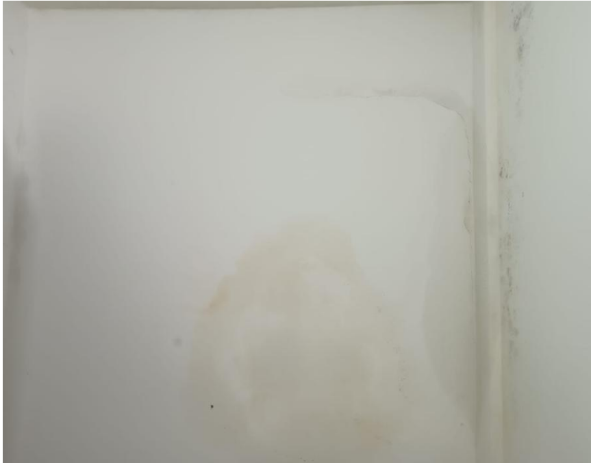
FIGURA 15 – Manchas de umidade
