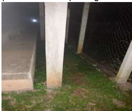
Figura 21 - Desnível da arquibancada e pilar obstruindo passagem
