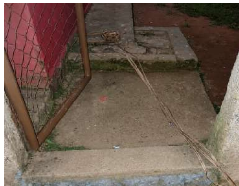
Figura 22 - Desnível na área do campo
