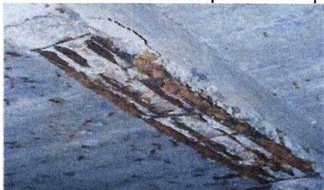
FIGURA 7.0- Corrosão das armaduras provocada por íons cloretos
