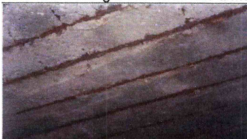
Figura 6.0- Corrosão generalizada nas armaduras
