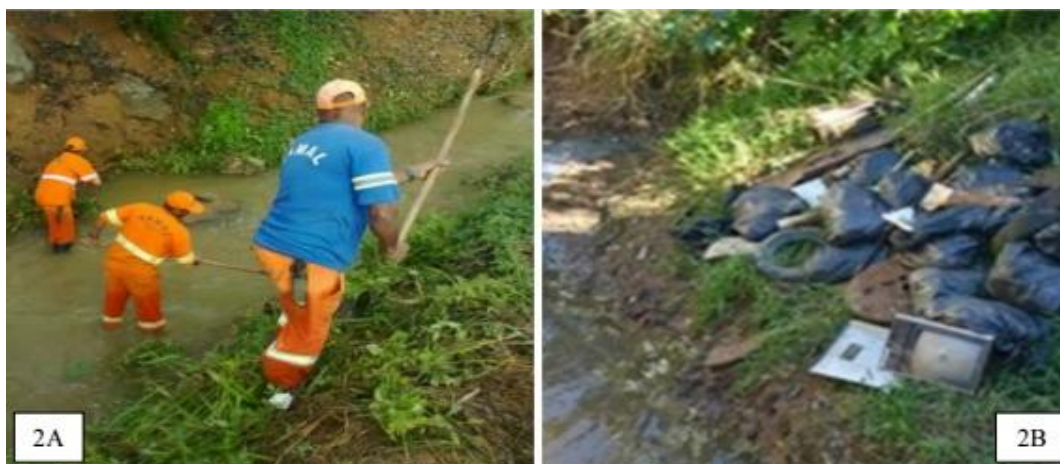
FOTO 2- Resíduos retirados do Rio Manhuaçu, após limpeza, em 2013.
