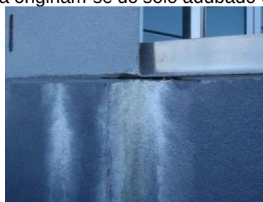
Figura 5 - Parede com eflorescência. (Fonte: Ibraclube, 2016).
