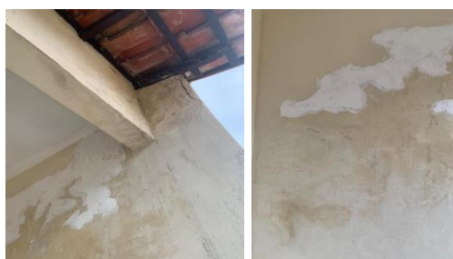
Figura 11 - Patologia na parede e viga da varanda com revestimento em reboco, argamassa e pintura. (Fonte: A autora, 2020).
