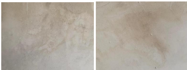
Figura 12 - Eflorescência, manchas e bolor na parede de estudo. (Fonte: A autora, 2020).
