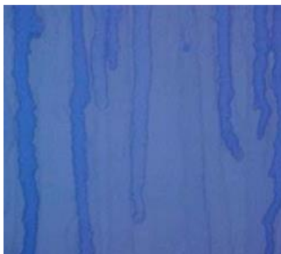
Figura 3 - Parede com goteiras e manchas. (Fonte: Ibraclube,2016).
