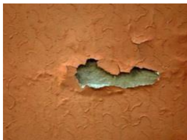
Figura 7 - Parede com descolamento. (Fonte: Ibraclube, 2016).
