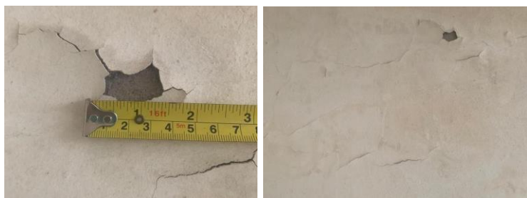
Figura 10 - Descolamento com empolamento da argamassa de revestimento medindo 3 cm, efeito da umidade sobre o reboco. (Fonte: A autora, 2020).
