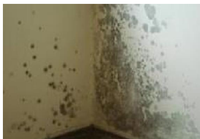
Figura 4 - Parede com mofo. (Fonte: Ibraclube,2016).
