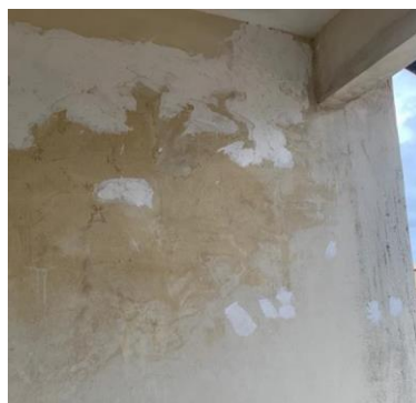
Figura 9 - Patologia na parede da varanda com revestimento em reboco, argamassa e pintura.
