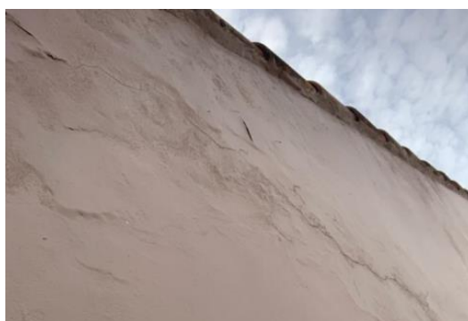
Figura 13 - Área externa da parede de estudo apresentando fissuras e descolamento.
