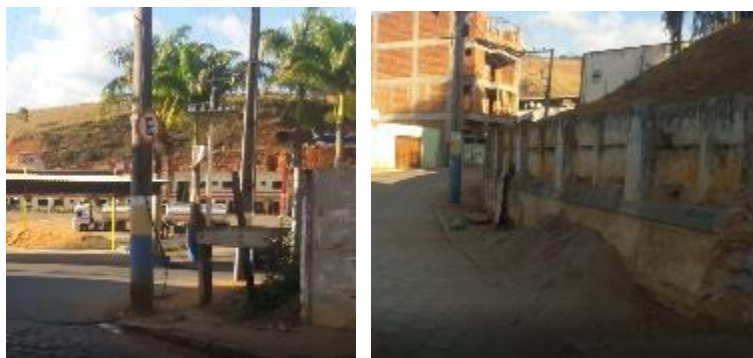
Figuras 30 e 31 – Obstrução das calçadas nas ruas São João e Santo Antônio respectivamente (Fonte: A AUTORA, 2020)
