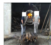
Figura 3: Abastecimento da caldeira pelos operadores
