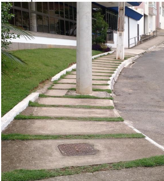
Figura 8 – Calçada da Câmara Municipal de Manhuaçu
